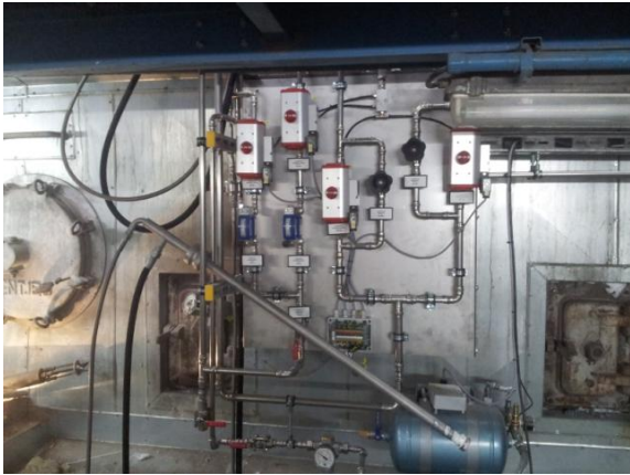
Bild 3: Verteilereinheit und Lanze vor Ort
