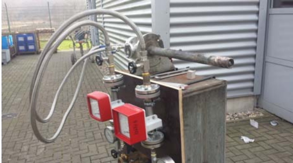
Bild 1: Prüfstand für die Optimierung der Eindüsung
