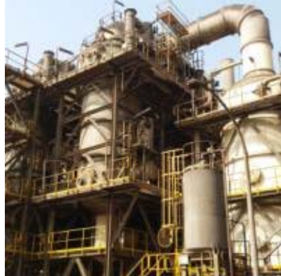
Bild 2: Nasselektrofilter und Quenche
