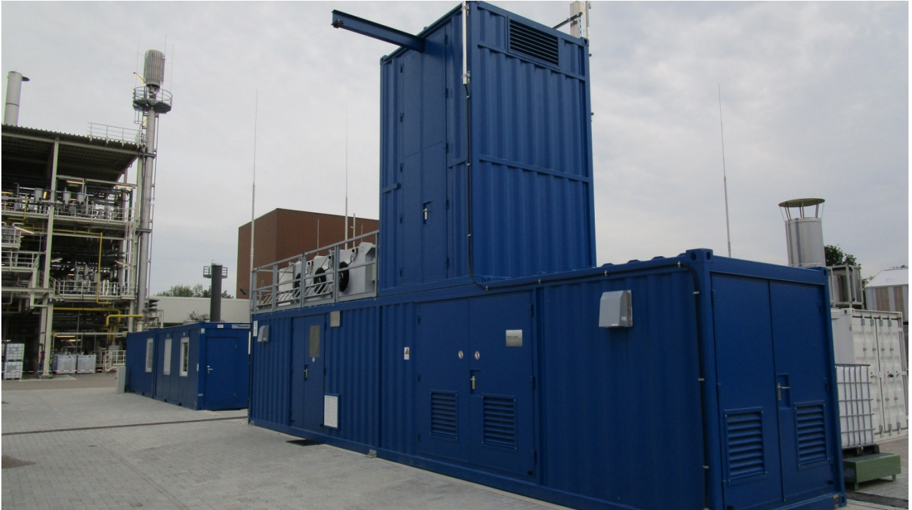
Bild 1: Containeranlage auf dem KIT Forschungsgelände - Campus Nord- Eggenstein-Leopoldhafen
